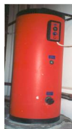
Κεντρικό μπόιλερ ζεστού νερού με θερμομονωτικό μανδύα.
