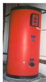
Κεντρικό μπόιλερ ζεστού νερού με θερμομονωτικό μανδύα.
